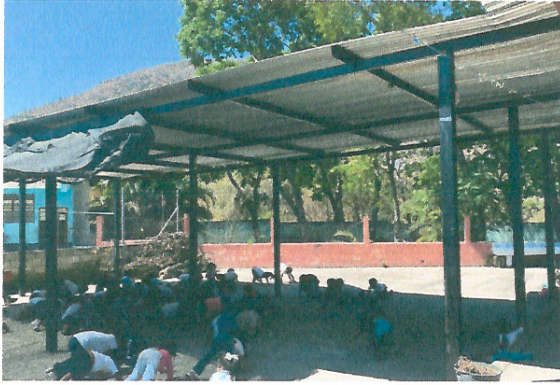
Foto 1: Remozar el techo del patio porque tiene saram.
